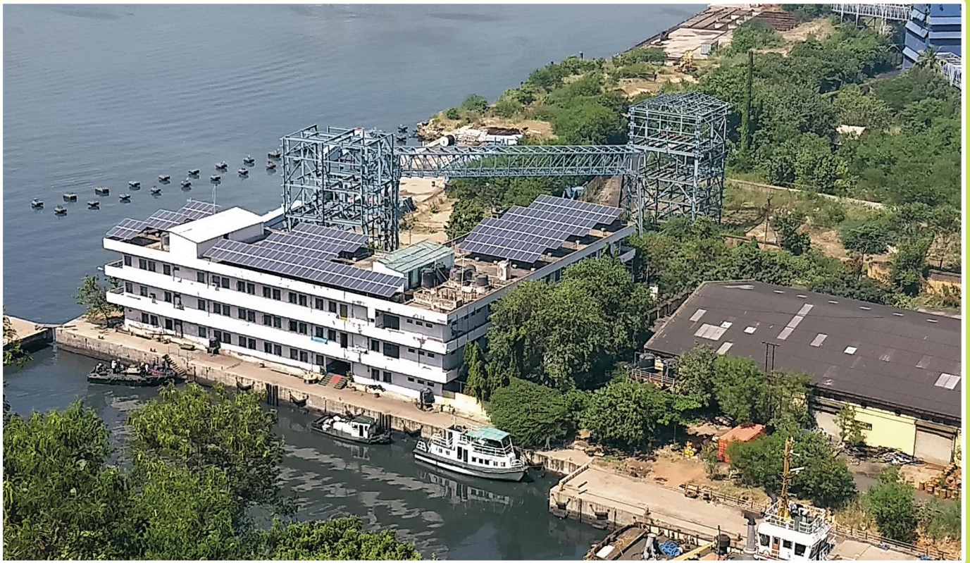
प्रचालन भवनों के रूफ टॉप स्पेस पर सोलॉर पॉवर प्लांट
